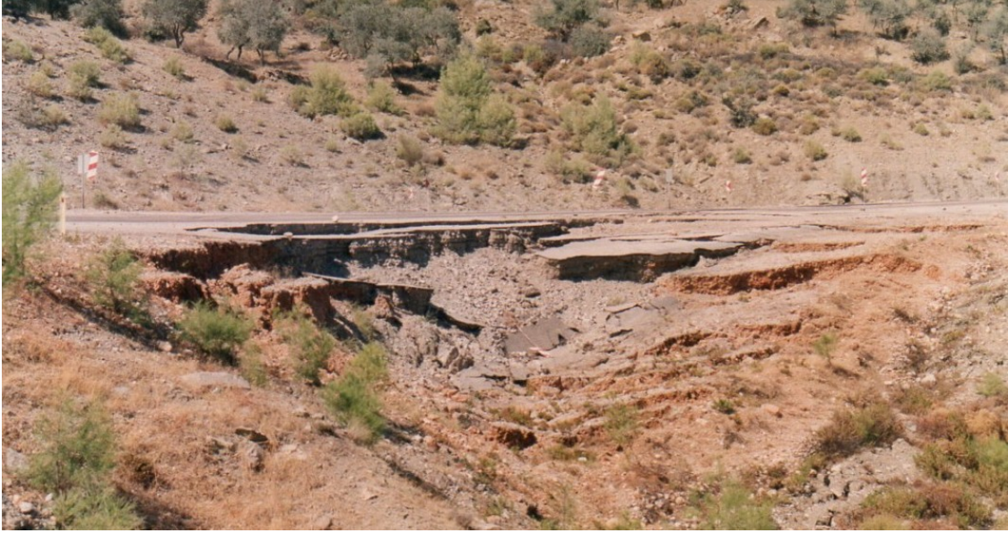
Fotoğraf 2. Kemer-Antalya Karayolunun 5. Kilometresindeki Heyelanlı Bölgede Tahrip Olmuş Karayolu
